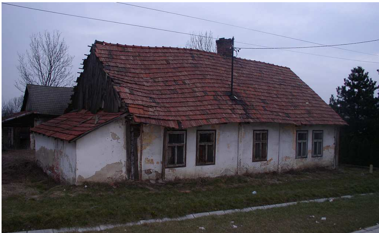
Fot. nr 139 (139-144). Kilka ujęć postępującej ruiny chałupy spod nr 166 (?), którą można datować na I ćwierć XX wieku. (15.03.2009)
