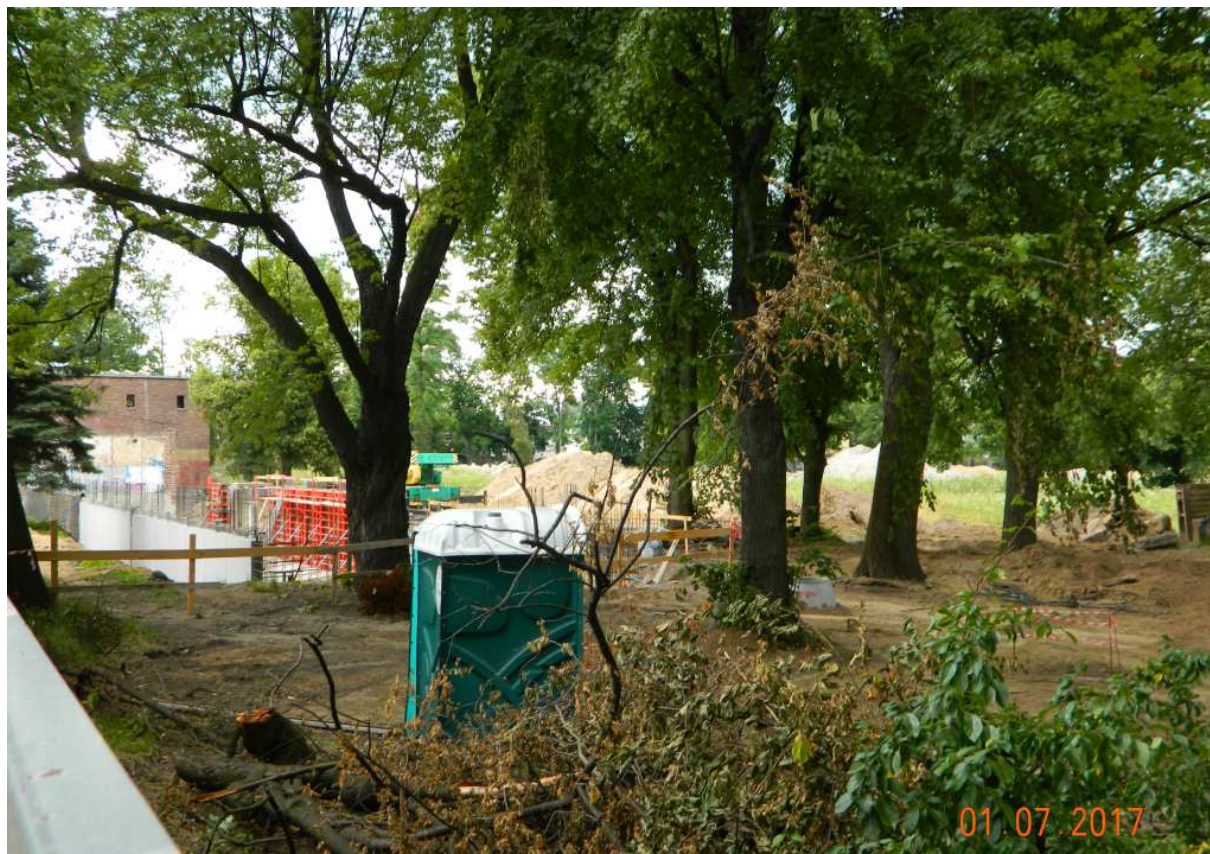
Fot. nr 158(158-159). Wyburzony budynek dawnych szatni, który ma zostać odtworzony.
