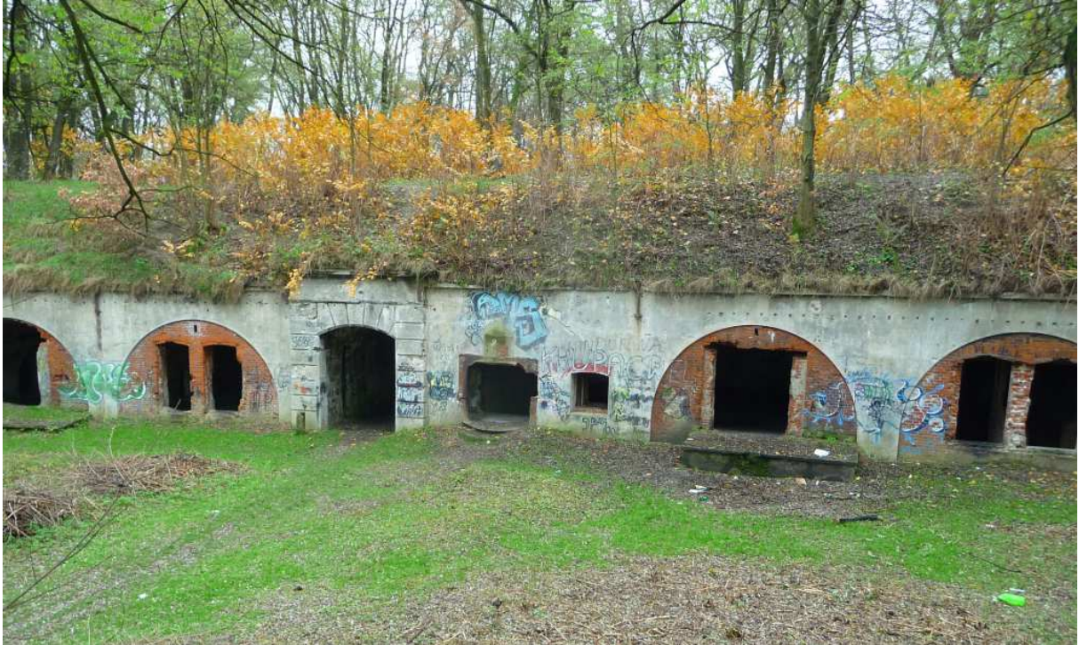
Fot. nr 226. Detale zrujnowanych koszar szyjowych. (18.11.2017)
