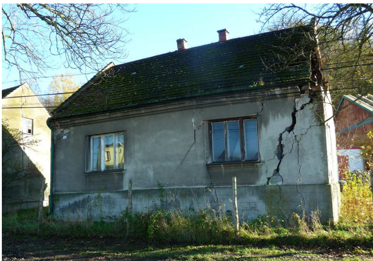
Fot. nr 163. Chylący się ku upadkowi powojenny dom murowany spod nr 20. (04.11.2017)
