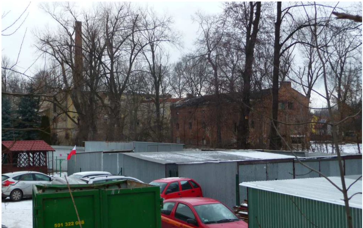
Fot. nr 4 (4-5). Widoki z ulicy Kocmyrzowskiej na zniszczony pożarem kompleks dawnego młyna Lelity spod nr 3a. (17.01.2018)
