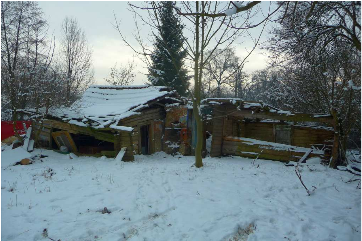
Fot. nr 90 (90-106). Ruina chałupy wybudowanej przy ulicy Kaczeńcowej 6 w roku 1898, co poświadczał napis na belce. (24.01.2018). Fot. nr: 90-98 - ujęcia od strony ulicy na pozostałości fasady i jej zachowane jeszcze detale.
