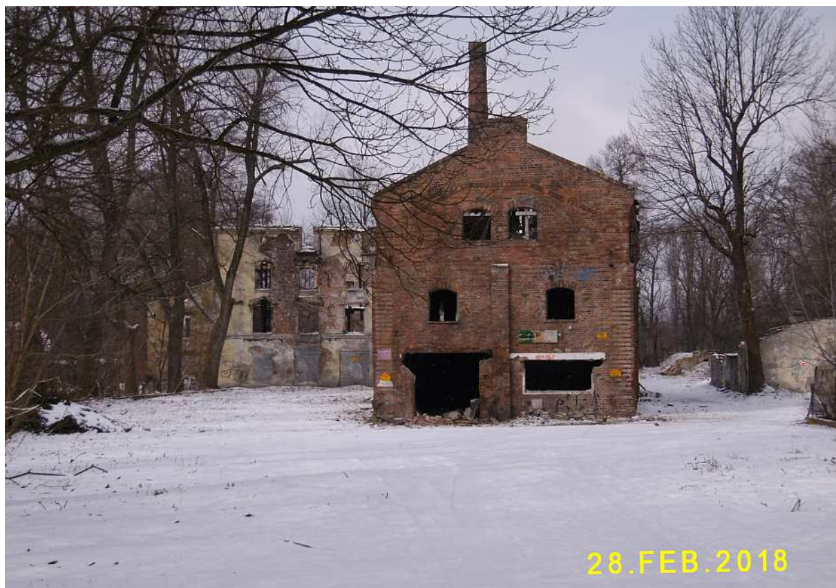
Fot. nr 10 (10-15). Zrujnowane pożarem budynki młyna.
