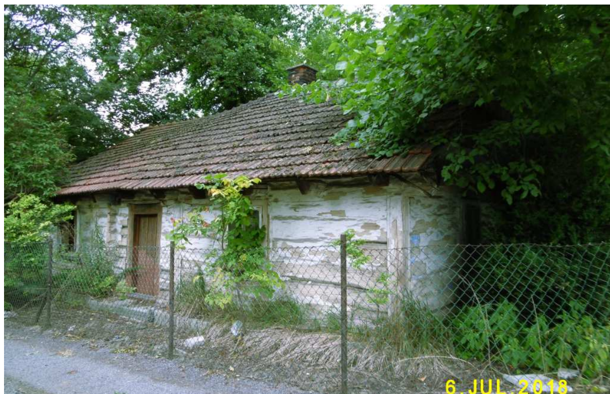
Fot. nr 221(221-231). Ruina chałupy z ulicy Wańkowicza 163. W stosunku do stanu z roku 2009 obiekt ten uległ całkowitej dewastacji. Fot. nr: 221-224- fasada obiektu i jej detale.
