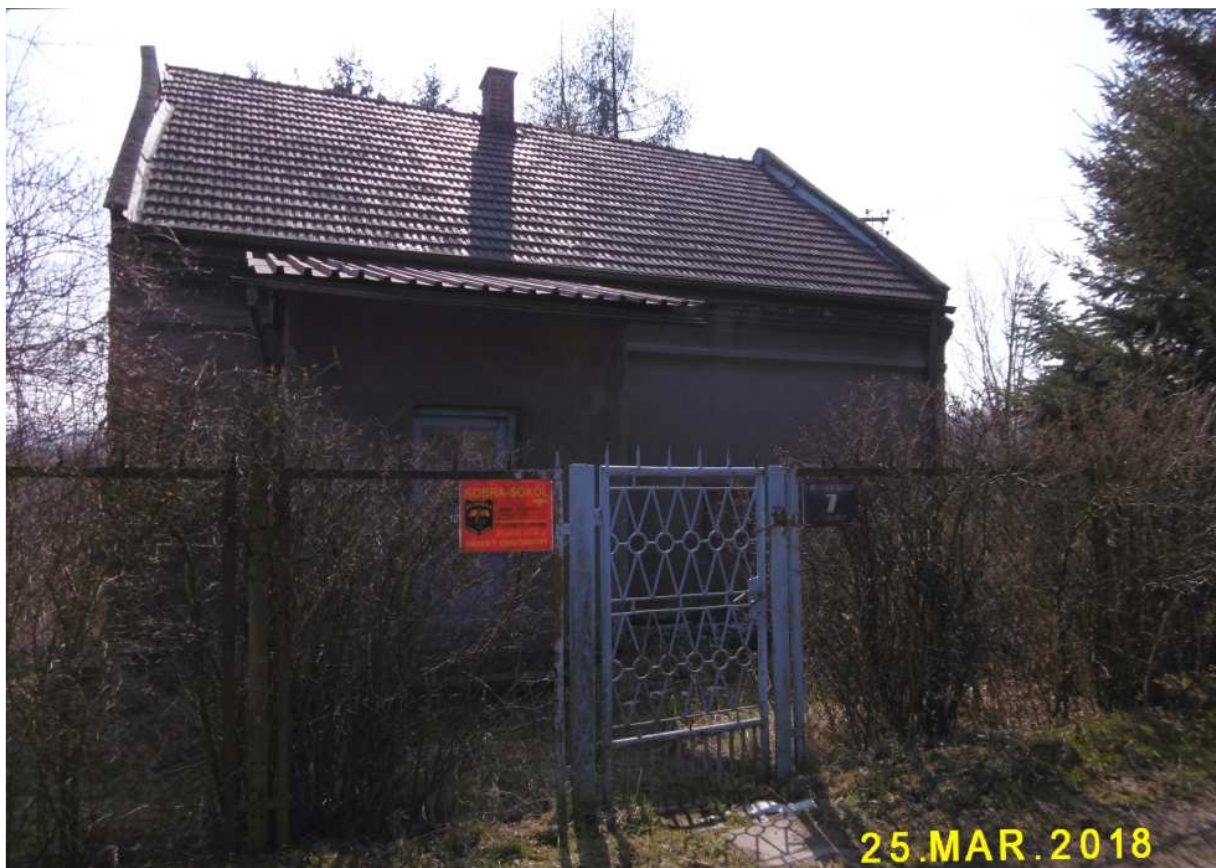
Fot. nr 185 (185-187). Opuszczona zagroda przy ulicy Hoborskiego 7.
