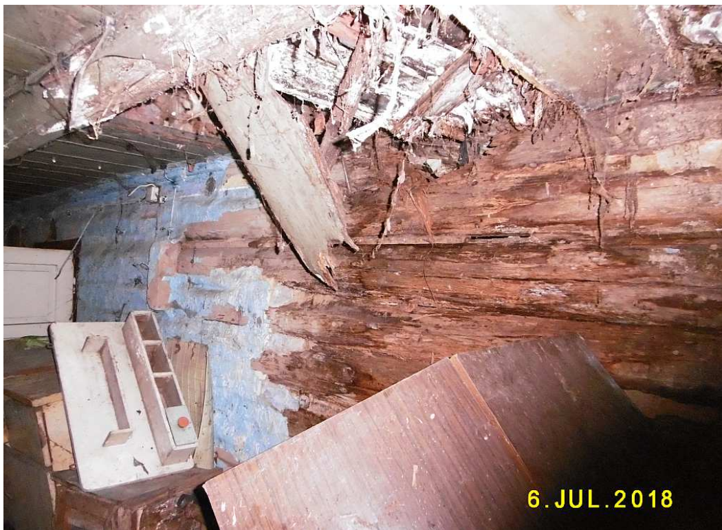
Fot. nr 230 (230-231). Prawa izba od strony podwórka. Tu przegnite belki.
