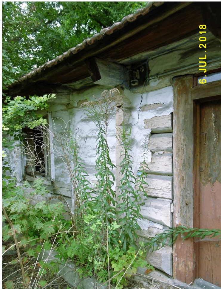
Fot. nr 224. Futryna okna już bez okiennych skrzydeł.
