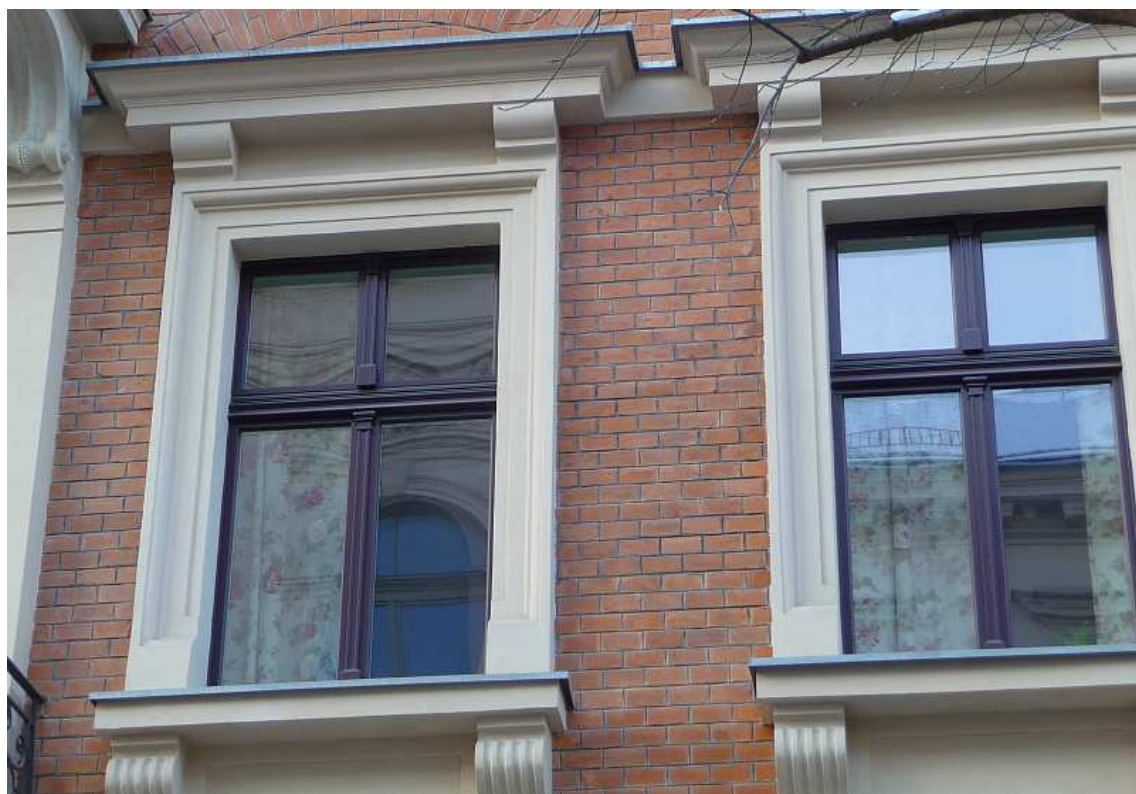
Fot. nr 65. Musi cieszyć, że przy wymianie okien zachowano dawne detale. (22.01.2018)
