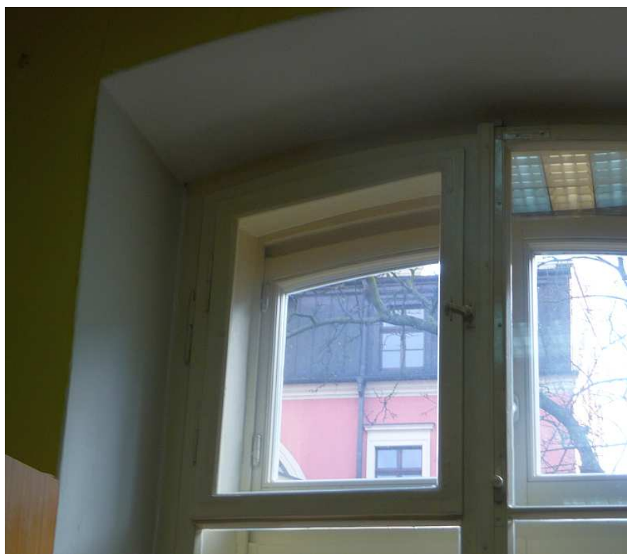
Fot. nr 115. Uchylny lufcik w górnym fragmencie lewego skrzydła okna. (05.02.2018)
