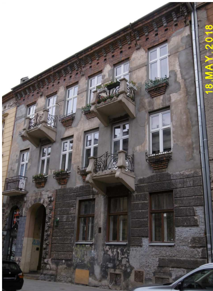
Fot. nr 133 (133-134). Przykład niszczenia pierwotnego wystroju fasad. Kamienica z ulicy Czystej 19, gdzie oryginalne okna znajdują się jeszcze tylko na parterze.
