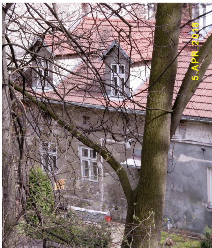
Fot. nr 183. Oryginalne okna czterokwaterowe, które w fasadzie zostały zastąpione przez bezpodziałowe plastiki.
