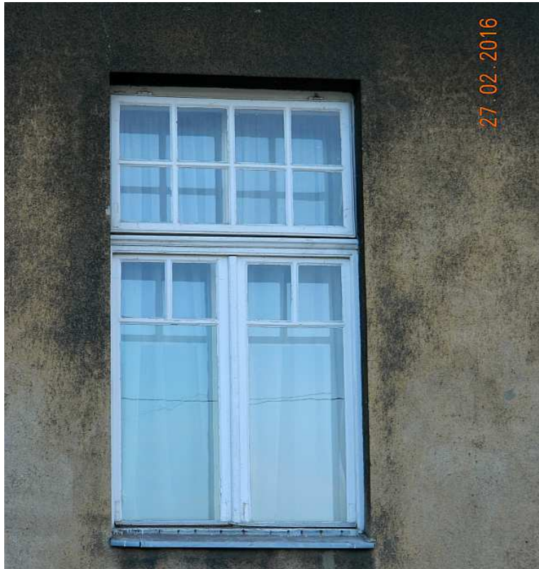
Fot. nr 34. Jedyne oryginalne okno o cechach modernistycznych.
