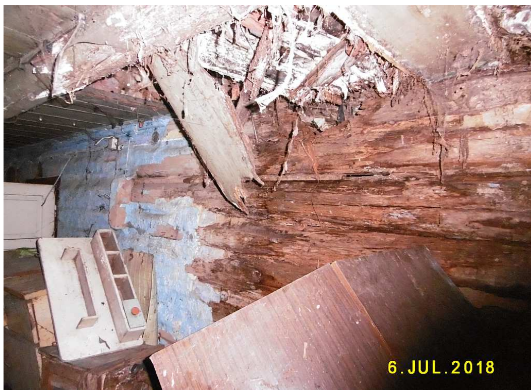
Fot. nr 278e. Wnętrze prawej izby od strony podwórka i przegnite belki ściany.
