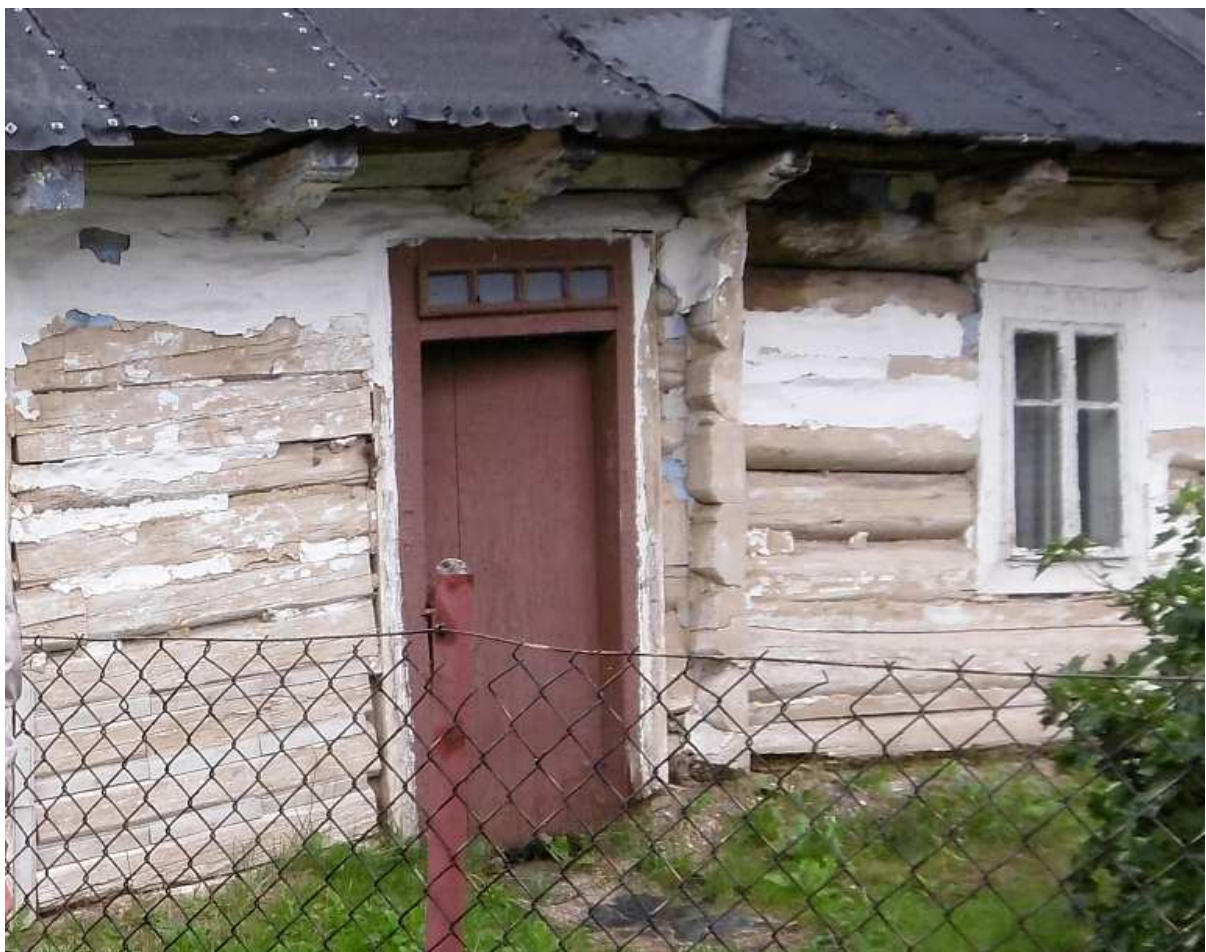
Fot. nr 276. Fragment tylnej części chałupy. Widać gnijące już dźwigary i fragmenty belek, co nie wróżą jej długiego żywota.
