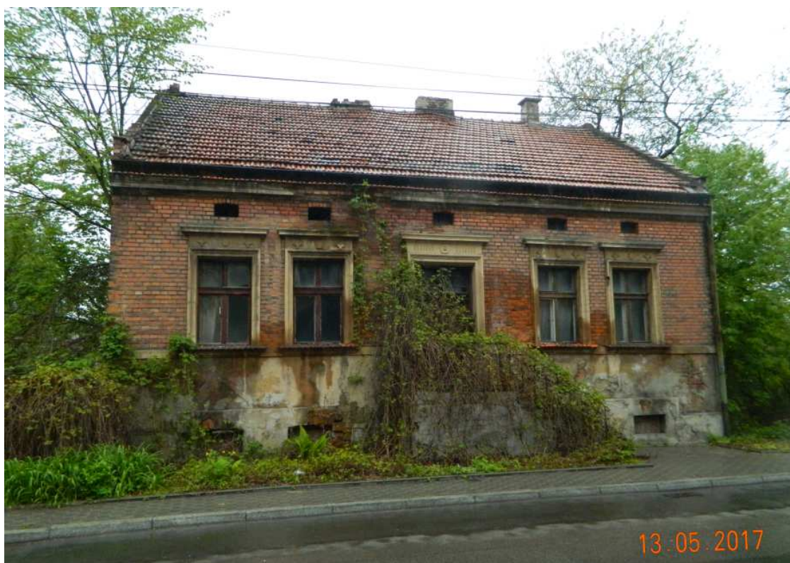
Fot. nr 121 (121-124). Popadający w ruinę, uroczy kiedyś domek z ulicy Królowej Jadwigi 57. Czy i on nie powinien być wpisany do rejestru zabytków, jak i inne zwierzynieckie domy z początku XX wieku?
