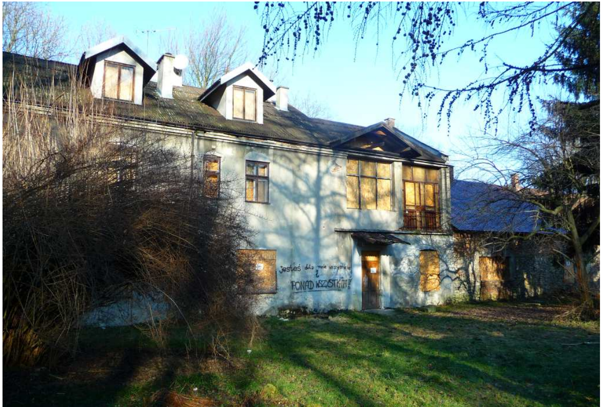
Fot. nr 201 (201-203). Kilka ujęć starego dworu Bemów z ulicy Mochnackiego 71, który popadł w nieodwracalną ruinę. A jeszcze w roku 2012 był zamieszkały. (14.01.2018)
