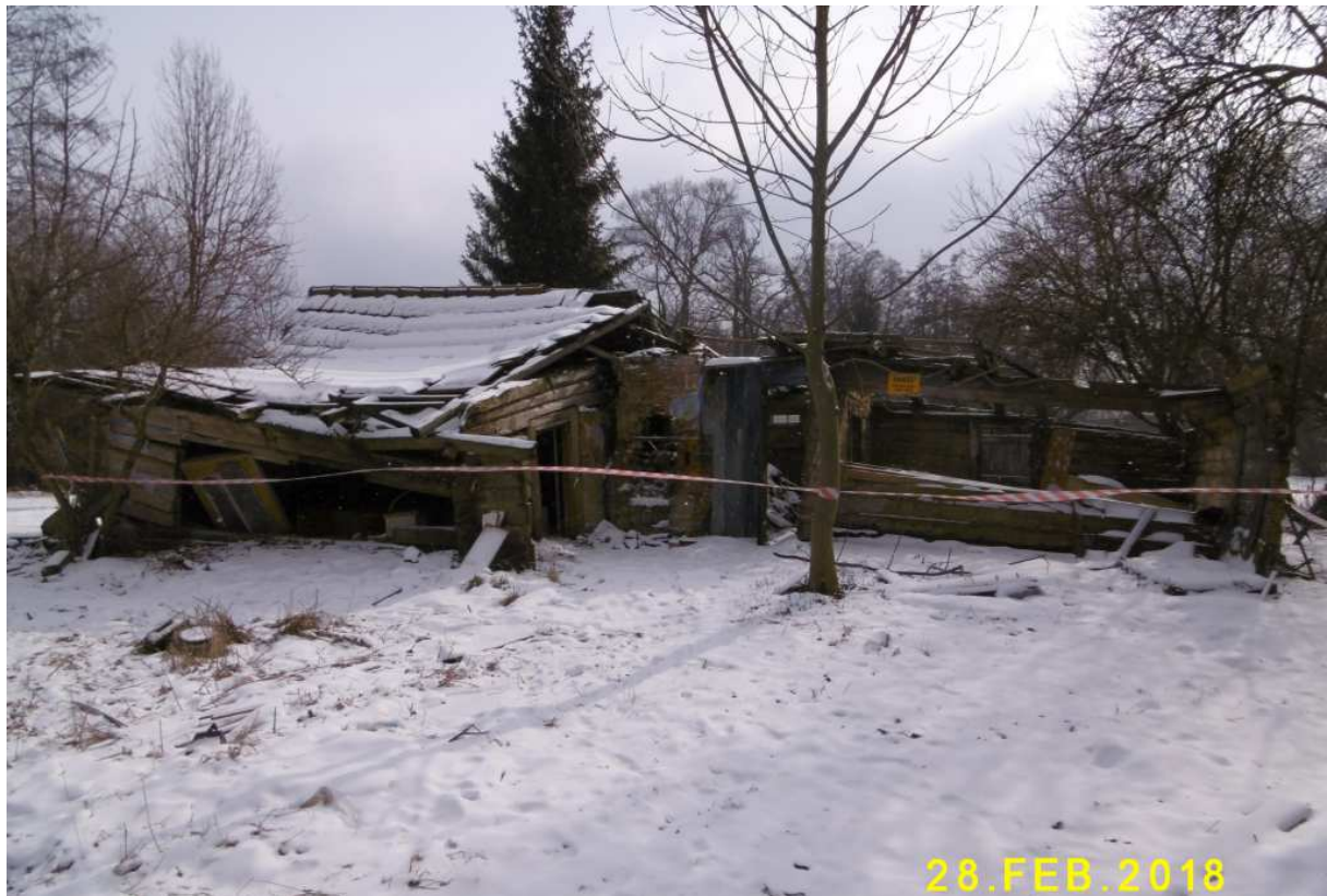
Fot. nr 135 (135-136). Ruina chałupy przy ulicy Kaczeńcowej 6.
