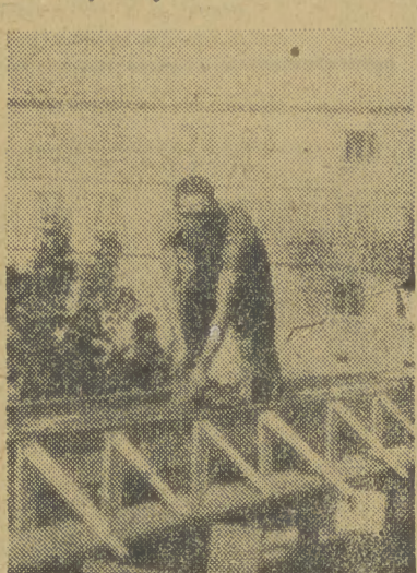
„Zbrojenia“ nowych bloków, których w Nowej Hucie codziennie przybywa. Na zdjęciu: Mieczysław Frankowicz rozpoczyna zbrojenie stropu na przyszłym gmachu mieszkalnym.
