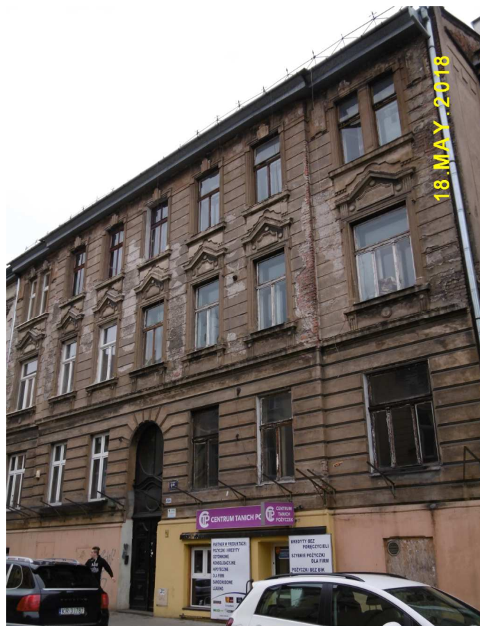
Fot. nr 118. Równie dramatycznie zaniedbana fasada kamienicy pod nr 16.
