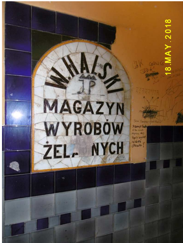
Fot. nr 6 (6-7). Oryginalne płytki sieni kamienicy z ulicy Szewskiej 23, które są w coraz gorszym stanie.
