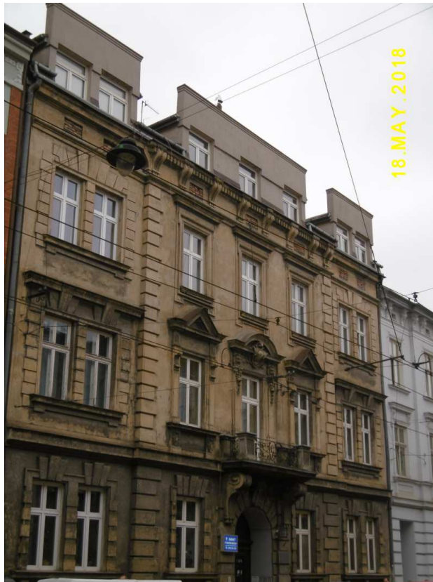
Fot. nr 59. Szpetna nadbudowa budynku pod nr 34.
