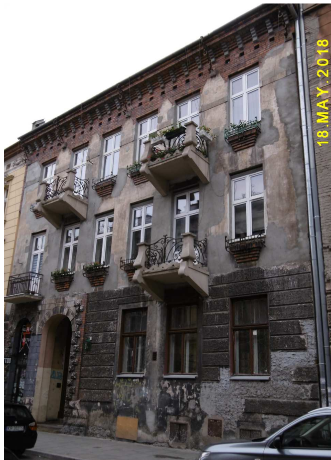
Fot. nr 115. Mocno zniszczona fasada kamienicy pod nr 19.
