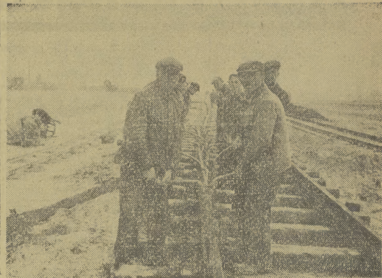
SPIESZY się załoga budowniczych nowej linii kolejowej — kończąc ostatni jej odcinek. Szybko, ale starannie i dokładnie trzeba ułożyć szynę na drewnianych podkładach — toczyć się po niej będą kółka tysięcy wielotonowych wagonów.
